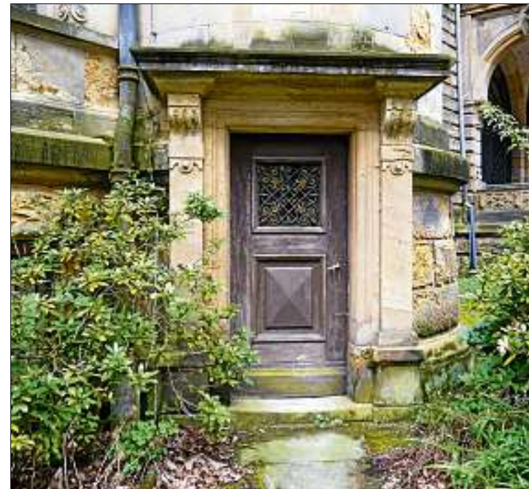
Die Fassade aus Sandstein ist akut von Feuchtigkeit bedroht, das Dach dringend sanierungsbedürftig.
