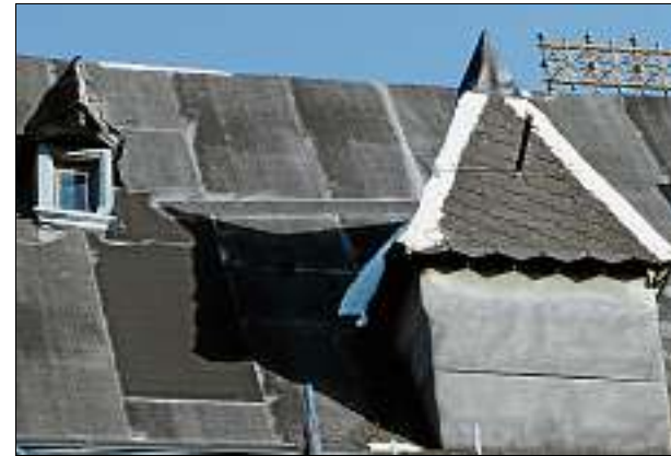
Das Dach am Westflügel ist ein Flickenteppich aus vergangenen Arbeiten.
