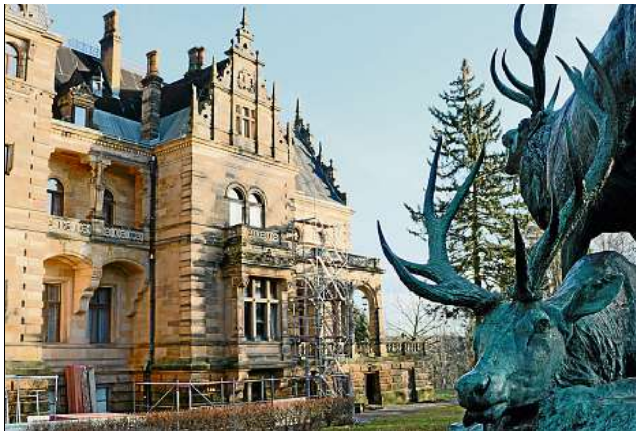
Die Sanierungsarbeiten am Neuen Jagdschloss Hummelshain begannen am Mittwoch mit dem Gerüstbau. In der kommenden Woche sollen die Dachdecker kommen, um am Westflügel zu arbeiten – der Wetterseite des Schlosses.
